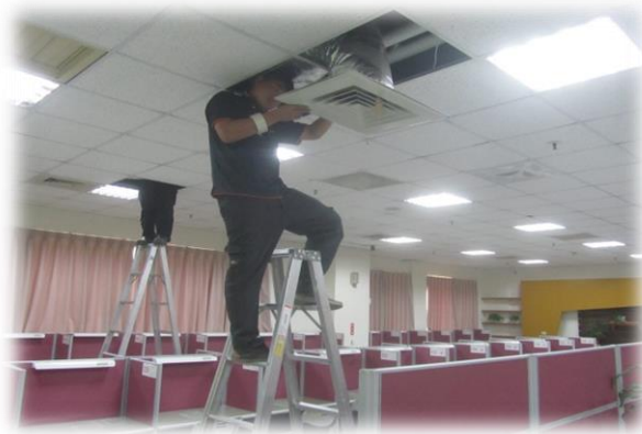
空調風管清潔更新
