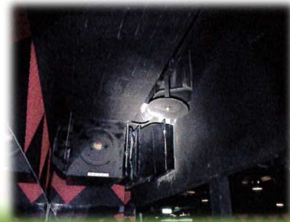
加大進氣口配管
