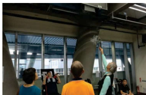
以發煙器判定全熱式交換器風管末端換氣效率較差
